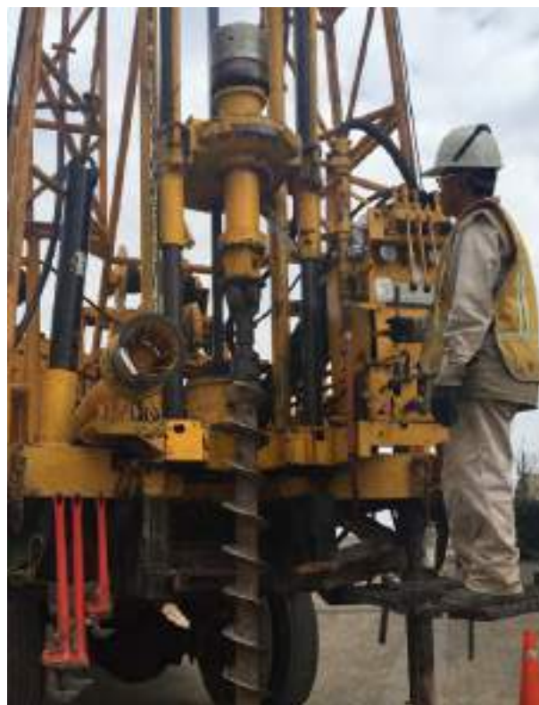
Los trabajadores operan cuidadosamente la maquinaria para ser precisos en el desarrollo de los labores
