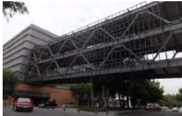
Vista del puente peatonal, elevado a tres niveles, en Avenida Obrero Mundial
