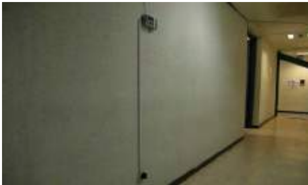
Radio receptores de alertas sísmicas en oficinas de la SOBSE
