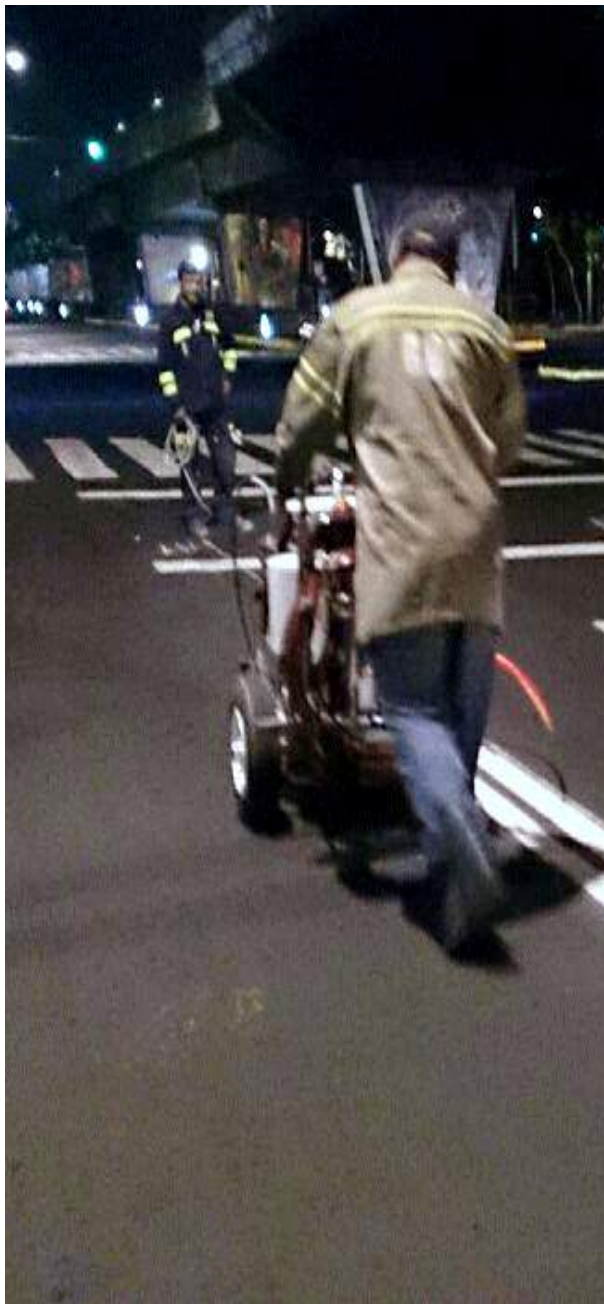
Balizamiento de línea Doble
